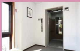
管理棟には エレベーターも設置。
